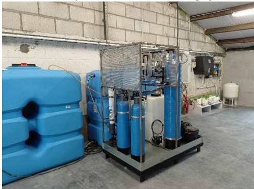
Foto: drinkwaterbereidingsinstallatie @'t hof Bellewaerde
